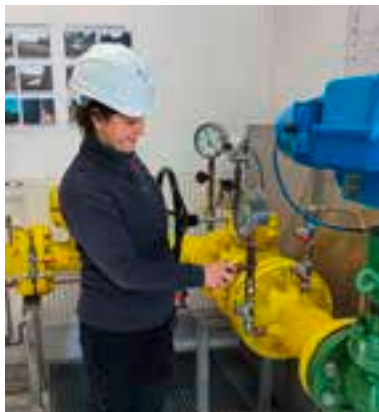
Die Rohre und Ventile werden bedient, um den Gasdruck zu mindern. Das Messgerät zeigt den Druck an.
