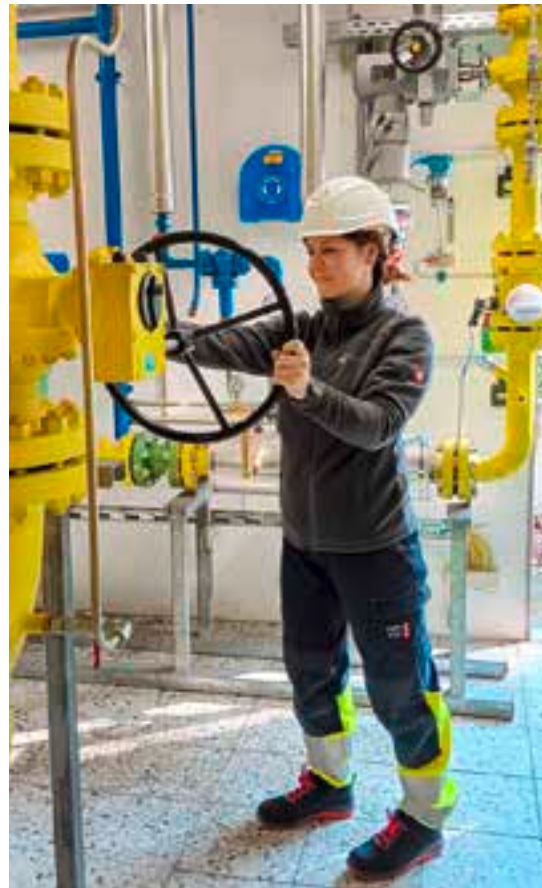
Jessica Axer aus dem Technischen Büro – Hausanschlussmanagement in der Gasdruckregelanlage am Hängelbach.
